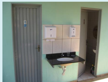
Figura 37: Lavatório de mãos
