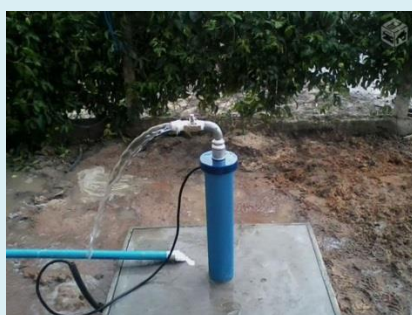
Figura 6: Poço tubular profundo com proteção
