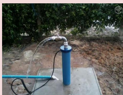
Figura 6: Poço tubular profundo com proteção
