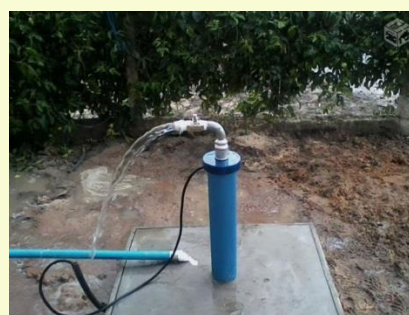
Figura 6: Poço tubular profundo com proteção
