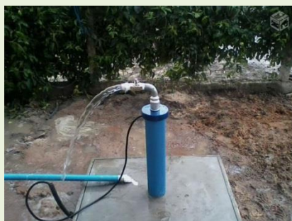
Figura 6: Poço tubular profundo com proteção
