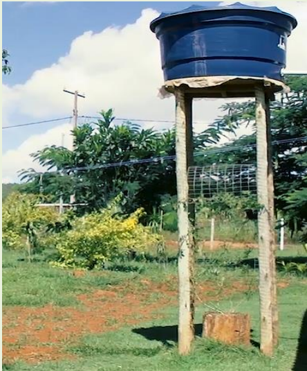
Figura 28: Captação da água.
