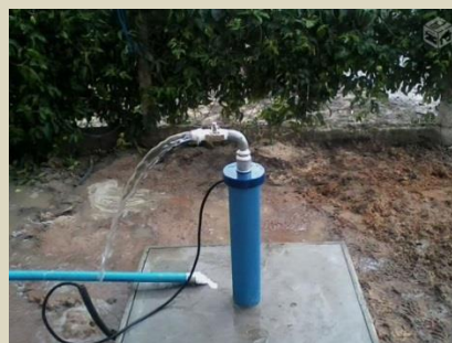
Figura 6: Poço tubular profundo com proteção
