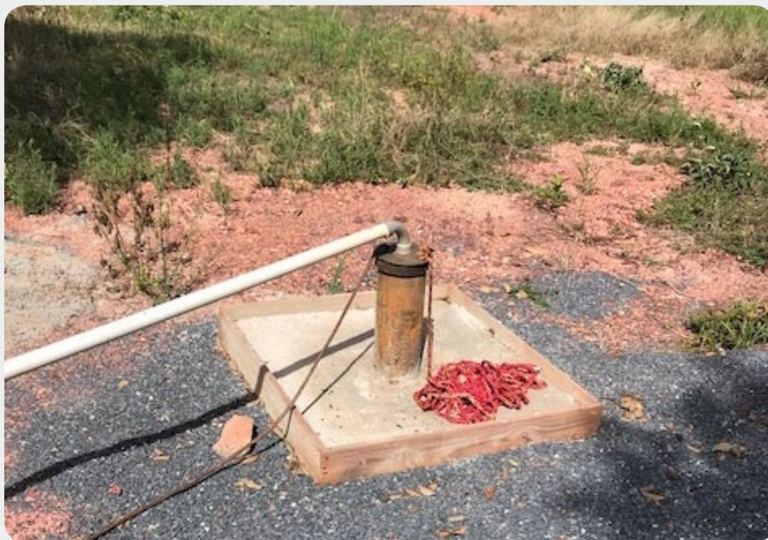
Figura 2: Poço tubular. Fonte: Emater-DF
