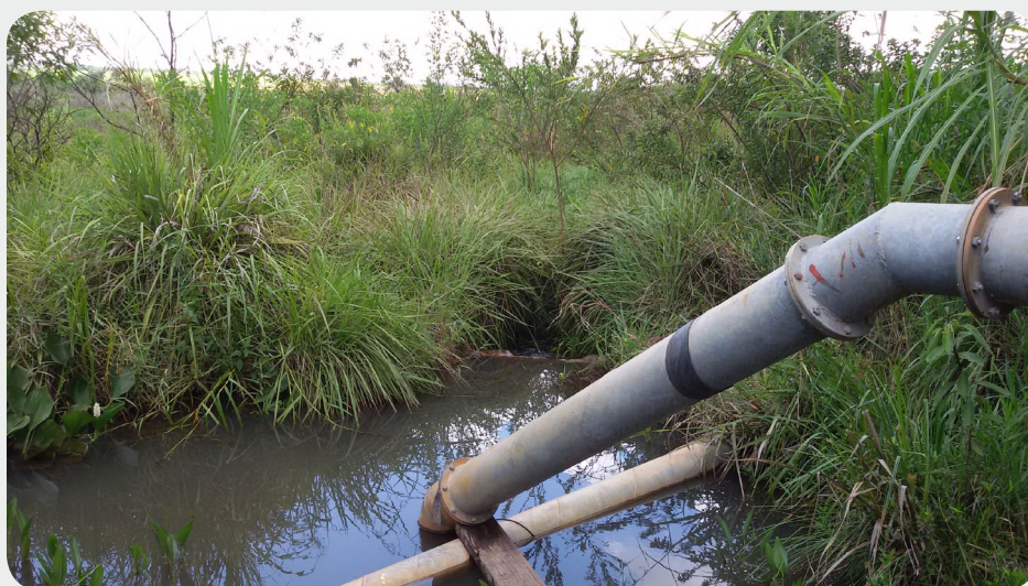
Figura 1: Captação de água em nascente. Fonte: Emater-DF
