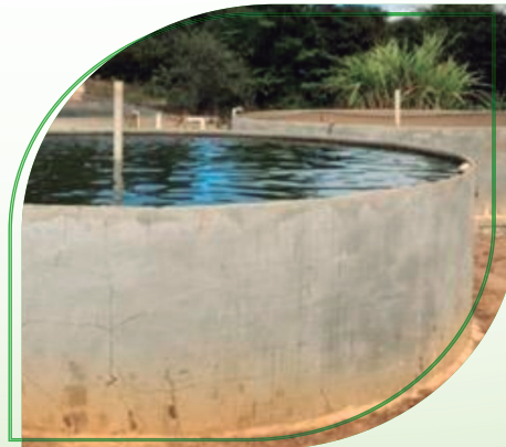
Figura 02. Vista geral dos tanques de ferrocimento utilizados na Fase 01.
