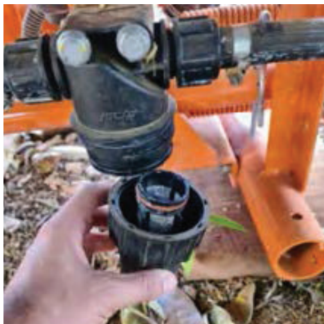
Figura 10. Desmontagem do filtro de linha para verificar excesso de impurezas e necessidade de lavagem da malha. Fonte: Felipe Cardoso
