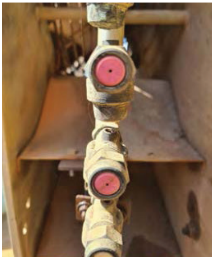
Figura 08. Detalhe dos bicos desgastados ou rachados que necessitam ser trocados. Fonte: Felipe Cardoso
