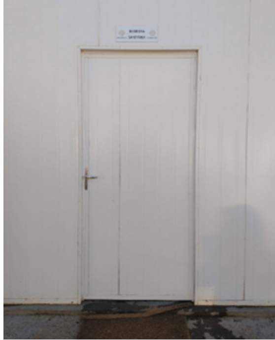
Figura 06 Porta com revestimento de isopainel de uma agroindústria Fonte: Emater-DF
