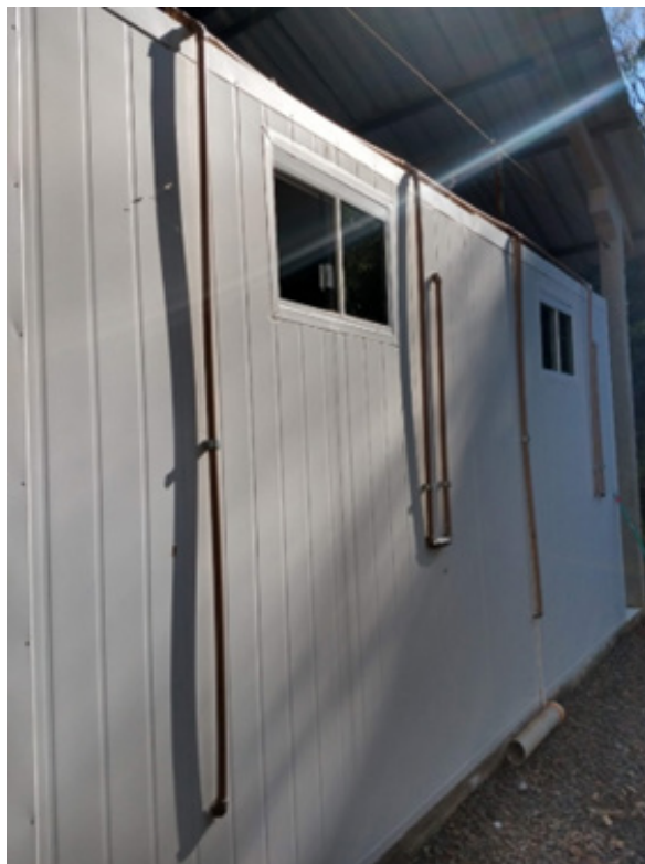
Figura 15. Instalações hidráulicas de uma agroindústria com encanamento aparente Fonte: Emater-DF
