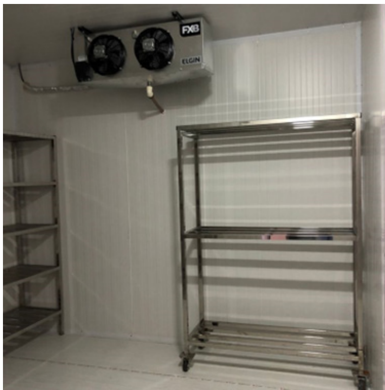
Figura 10. Câmara de armazenamento de uma agroindústria Fonte: Emater-DF
