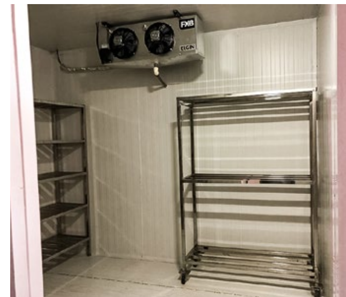
Figura 11 – Câmara de armazenamento refrigerada.
