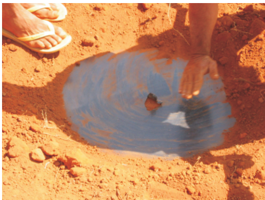
Figura 15. Furo na lona causado pela movimentação da enxada.
