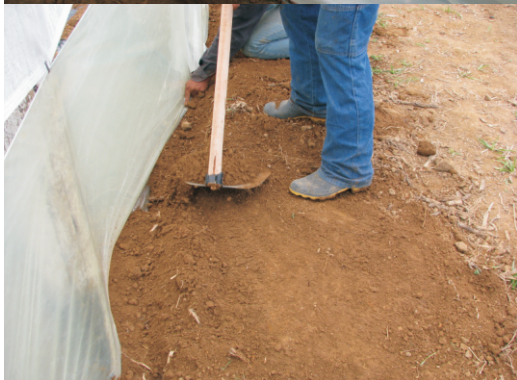
Figura 13. Colocação e aterramento do filme plástico que faz o fechamento da parte inferior da estufa.
