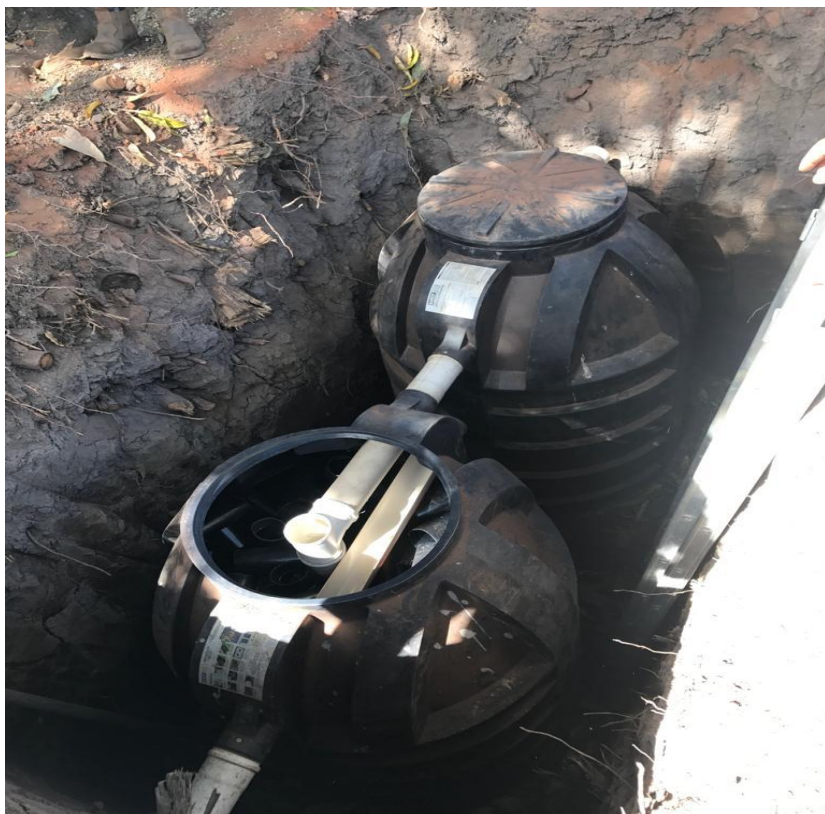
Figura 14. Tanque séptico com biofiltro.
