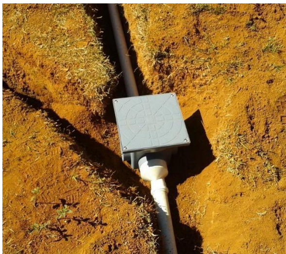
Figura 07. Caixa de inspeção ou de passagem.
