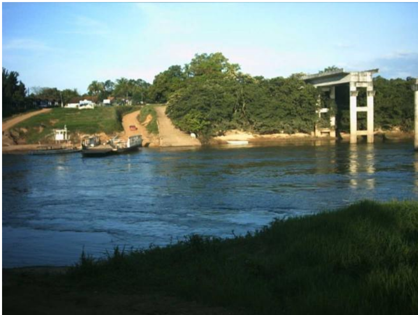
Figura 20: Travessia em Rio Sono e ponte inconclusa sobre o rio do Sono.
